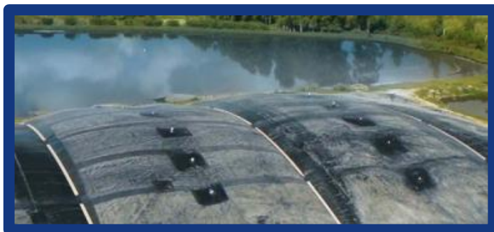
Système de captage et de valorisation du biogaz
