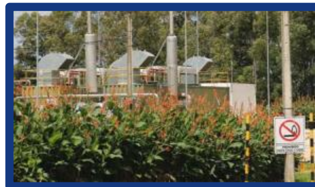
Site de transformation du biogaz en électricité, réinjecté à hauteur de 25% sur le site de peignage de Lanás Trinidad et revendu à 75%
